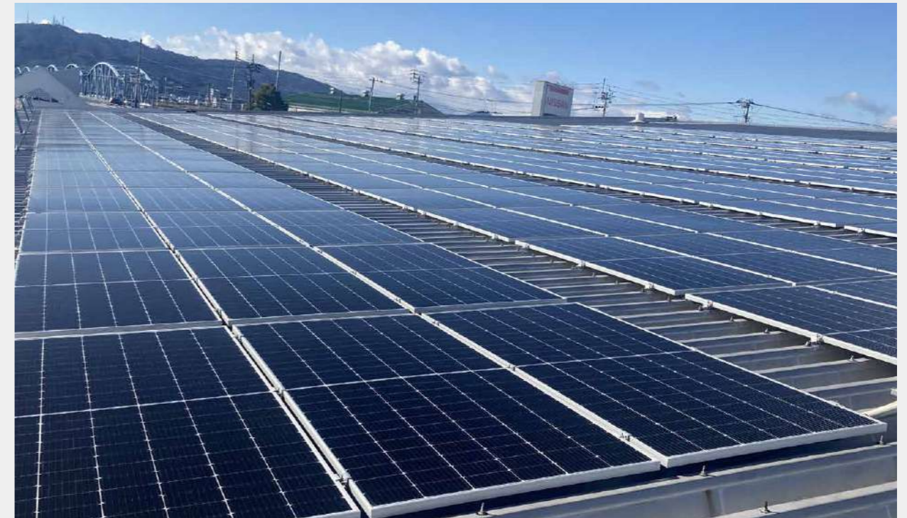
ショールーム屋上に設置した太陽光パネル
