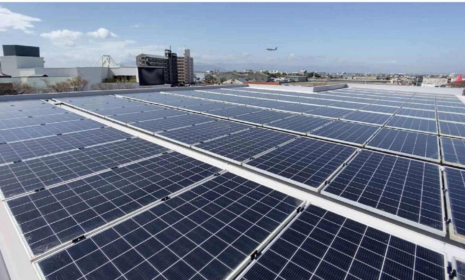
徳島本社屋上のソーラーパネル
